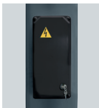
Quadro elettrico colonna secondaria.
