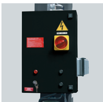
Quadro elettrico colonna principale con tutti i comandi di selezione e controllo.
